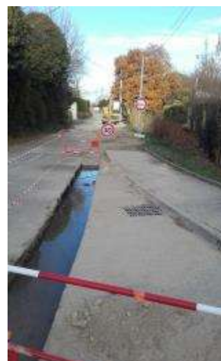
Passage de la conduite AEP sur le chemin de Thézan
